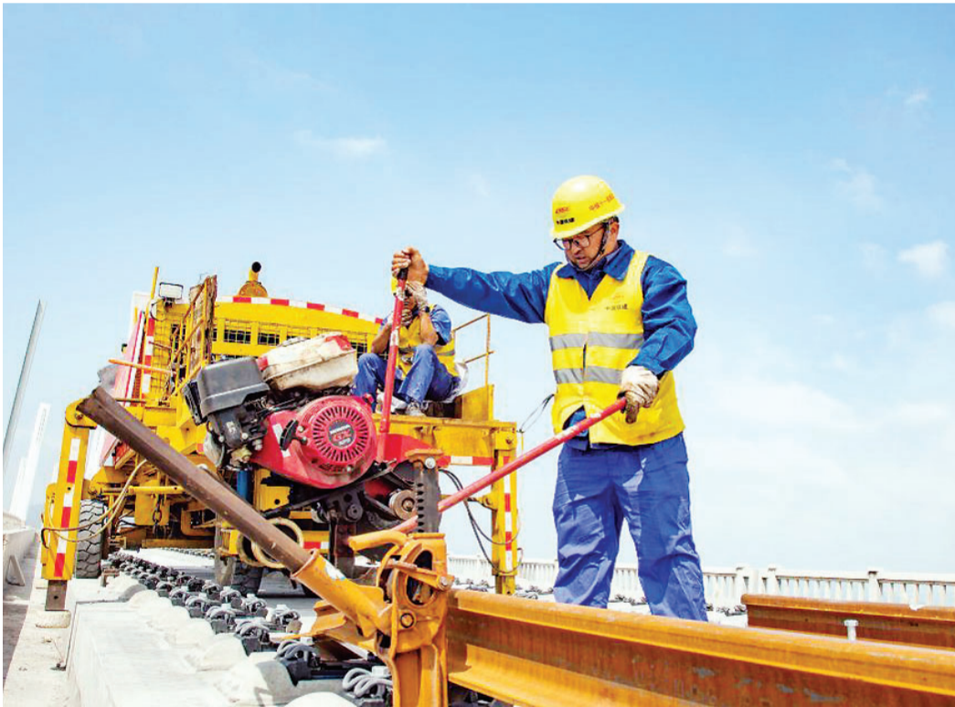
4月15日，工人在新建福廈鐵路湄洲灣跨海大橋施工。當日，由中鐵十一局承建的新建福廈鐵路湄洲灣跨海大橋順利鋪軌，為新建福廈鐵路早日建成通車奠定基礎。
